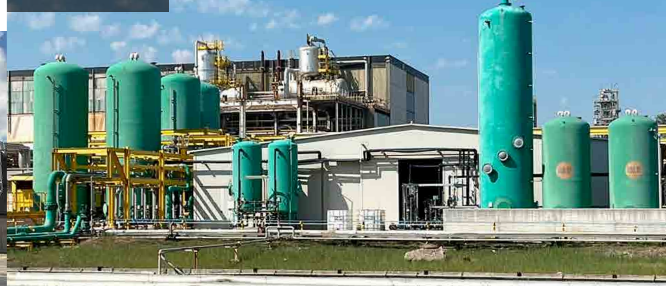
Sito di Brindisi - Impianto di trattamento acque Enipower
